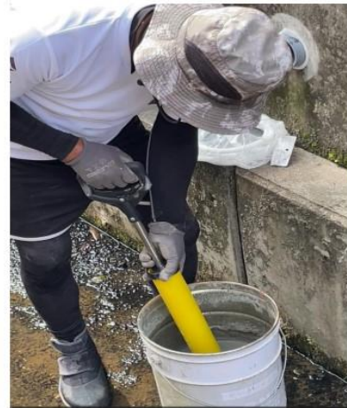
塩ビ管75パイ埋設 ハイフレックスを混ぜたモルタルをガンで吸う
